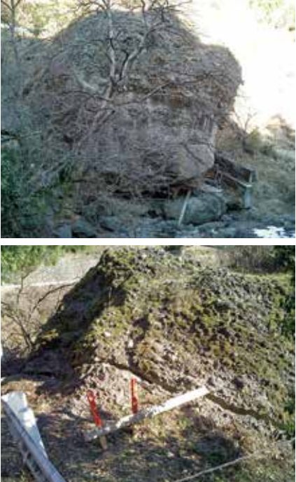
<上>施工前状況 <下>施工前亀裂部状況
